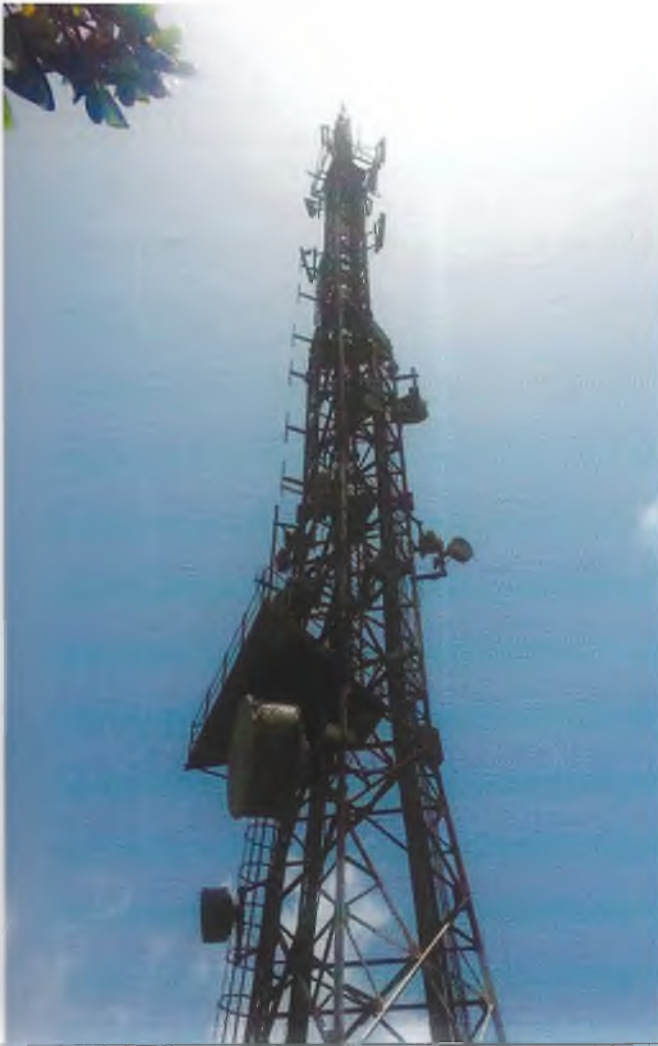
Antenne de Morne à Louis en Guadeloupe neutralisée grâce à l'énergie Kzétia Svam.
